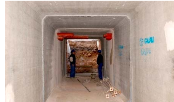
Galerías subterráneas registrables
