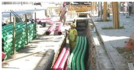
Nueva red de telecomunicaciones y eléctrica
